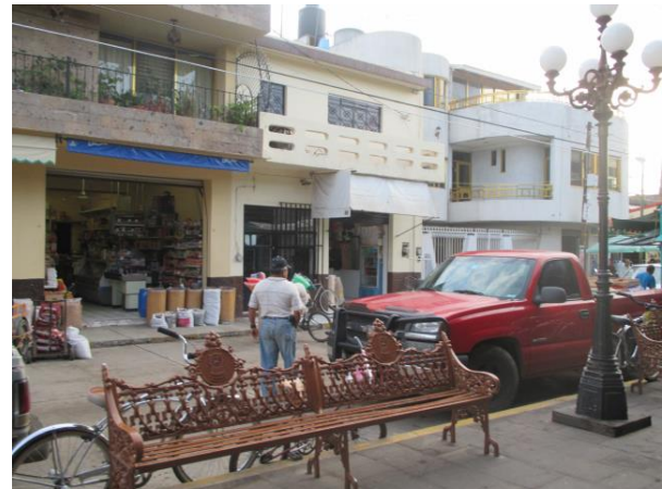
IMAGEN QUE EXPRESA LAS CONDICIONES FISICAS EN BUEN ESTADO DEL PAVIMENTO EN LA VIALIDAD/VP NACIONAL-OTE. Y GUERRERO.
